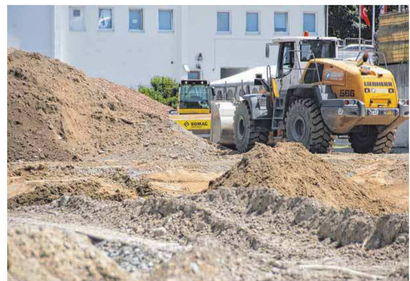
Zurzeit laufen auf dem ehemaligen ZG-Areal die letzten Abbrucharbeiten. Sind diese abgeschlossen, kann der Bau des Hotels beginnen. FOTO: SEK
